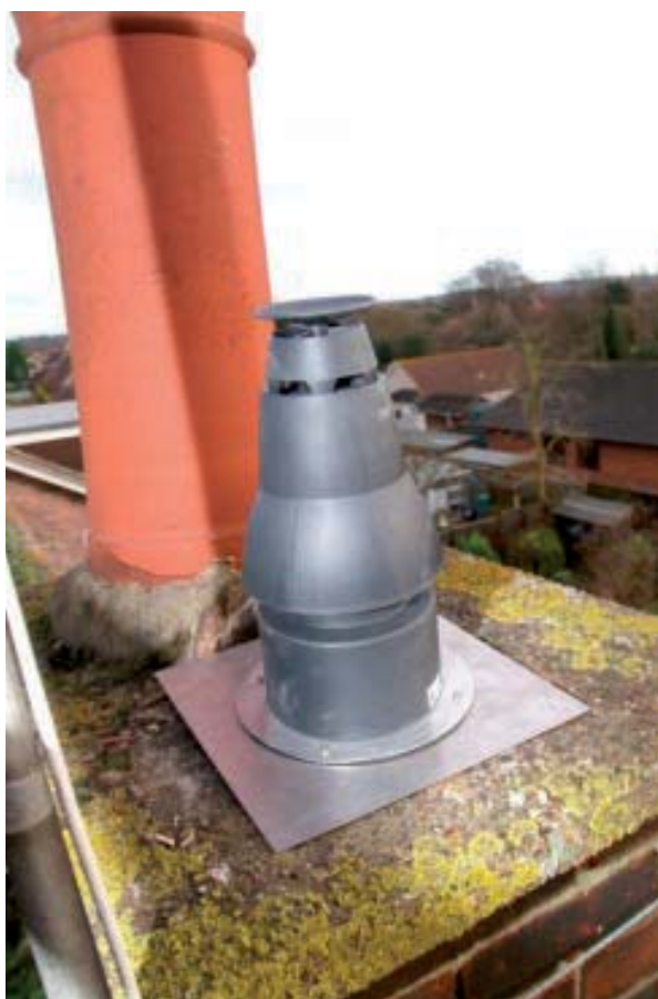
Figuur 12.4 Montage van de terminal. (© Muelink & Grol)
